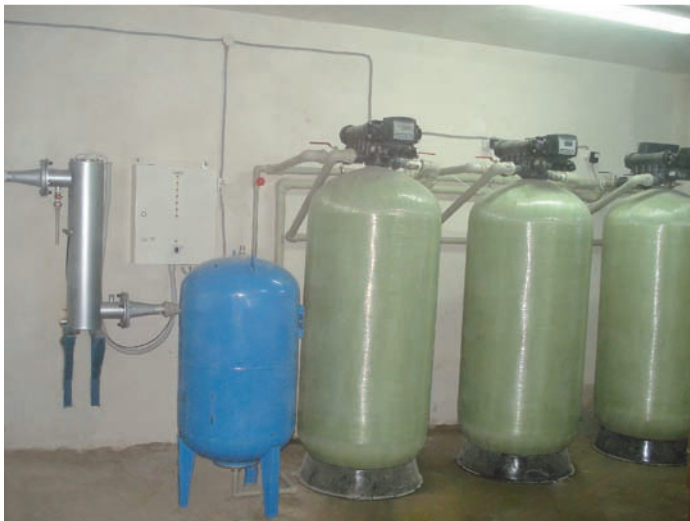
Рис. 2.3.5 Система механической очистки воды смонтированная в жилом комплексе "Искандер" г. Астана
