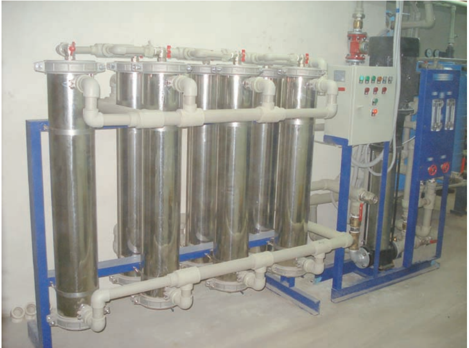
Рис. 2.3.2 Обратноосмотическая система производительностью 7 м3/ч, смонтированная в жилом комплексе "Искандер" г. Астана
