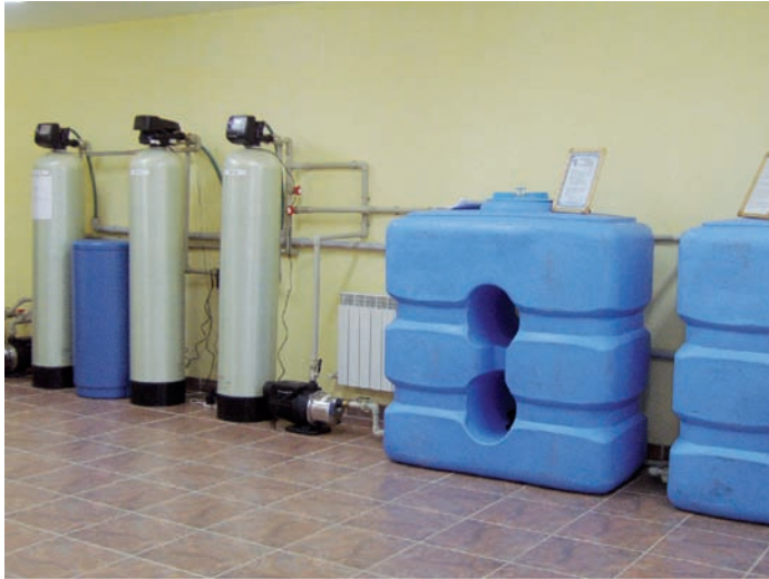
Рис. 2.3.4 Пример монтажа комплексной системы водоочистки в частном коттедже, г. Караганда
