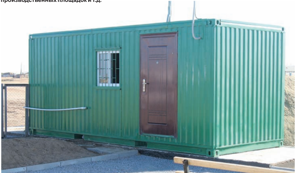
Рис. 2.3.7 Система водоочистки контейнерного исполнения смонтированная в поселке Каратерек.
